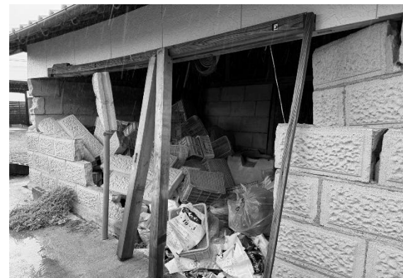
肥後れんこんの里・近藤さんの倉庫。外壁が崩れ、屋根が落ちない様に補強している。
