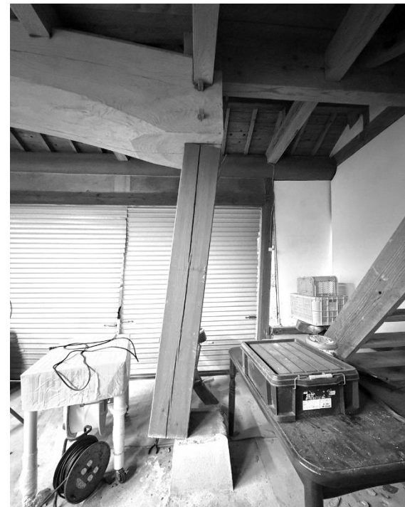
肥後あゆみの会・守屋さんの倉庫、基礎から外れた柱。間一髪で倒壊を免れました。守屋さんは震災当日、家の中にいましたが家族全員無事でした。
