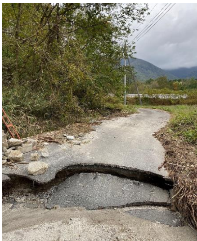
陥没した道路
