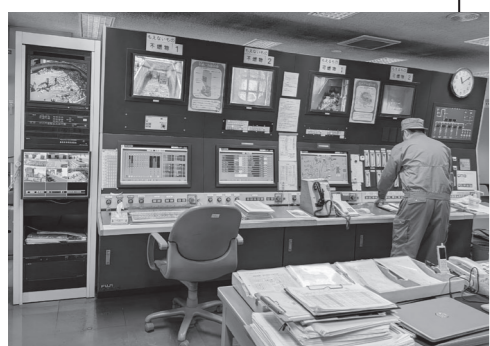
コンピューターで集中管理し工場全体を操業。
